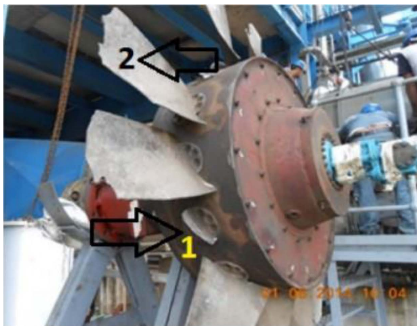
شکل ۴. دو نقطه آسیب دیدگی پره: شکستگی در ریشه پره (مشخص شده با شماره ۱) و شکستگی در یک سوم ارتفاع پره (مشخص شده با شماره ۲) [۱۰].
