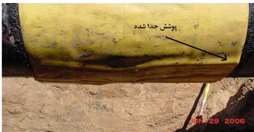
شکل ۱- پوشش جدا شده از سطح خارجی لوله [۱۱].
